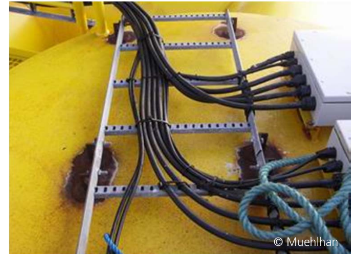
Beispiel für Schäden an Beschichtungen durch geschweißte Halterungen im Offshorebereich
