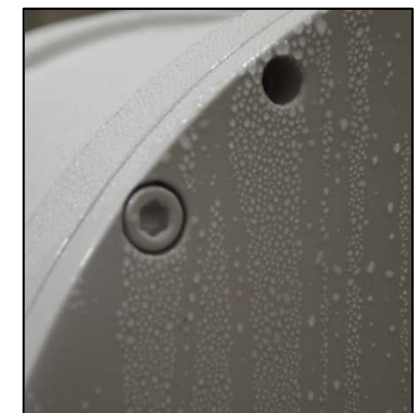
Taupunktunterschreitung an der Oberfläche einer Komponente
